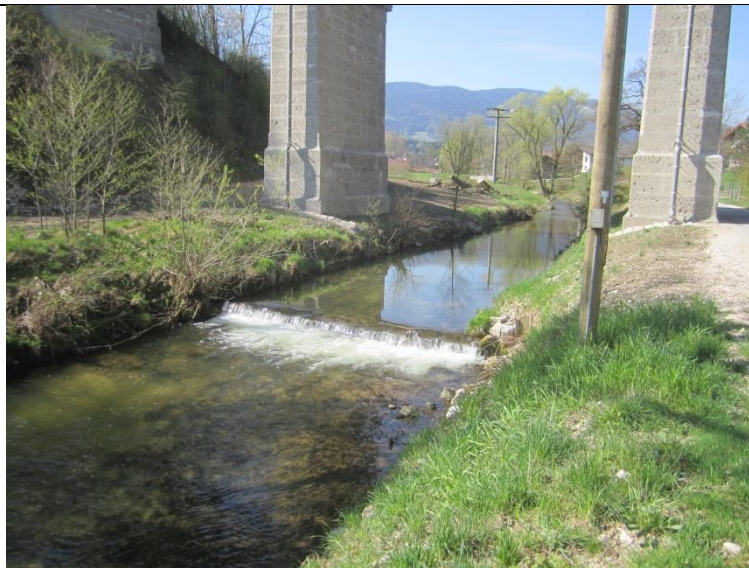
Absturz am Viadukt, Fkm 30,160 Markt Teisendorf
